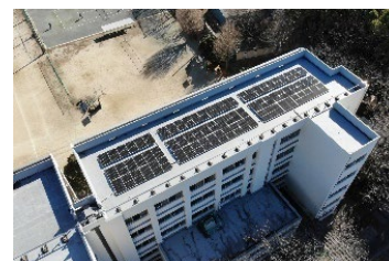
公共施設における太陽光発電システムの設置状況
