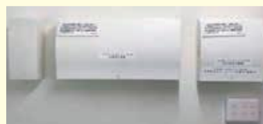
非常用コンセント盤
