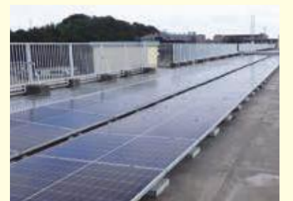
太陽光発電設備
