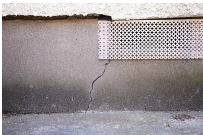
換気口付近の ひび割れ
