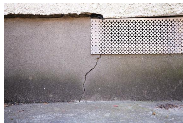
基礎のひび割れ
