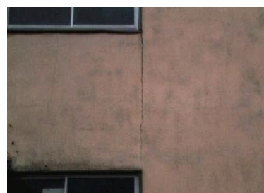
外壁の ひび割れ
