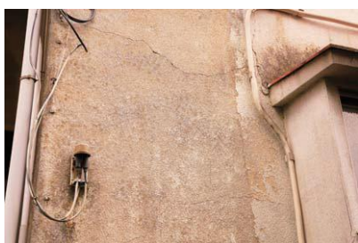
外壁のひび割れ ・コケ
