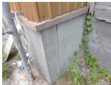
基礎の ひび割れ
