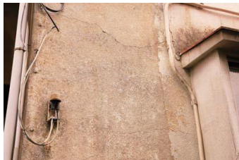
外壁のひび割れ・こけ
