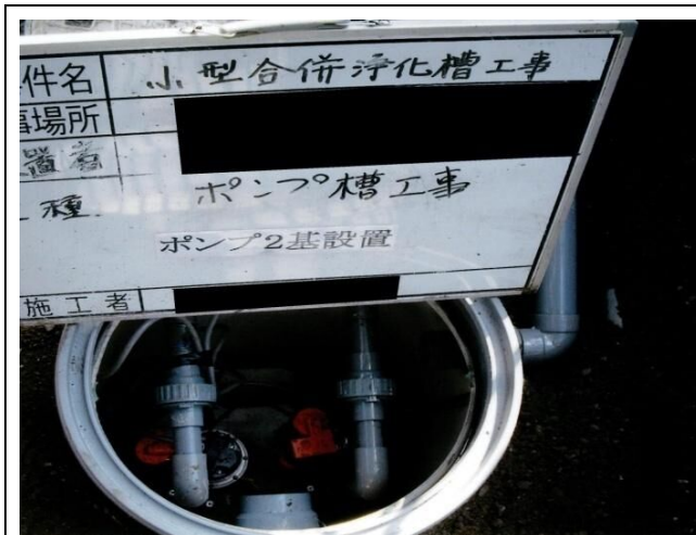
17. ポンプ設備の写真
