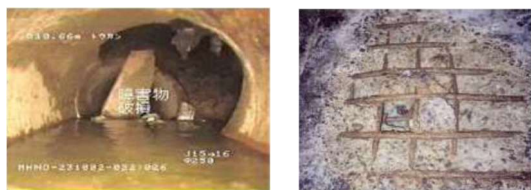
下水道管の老朽化の事例
