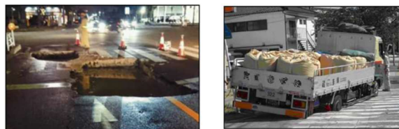
道路陥没の事例
