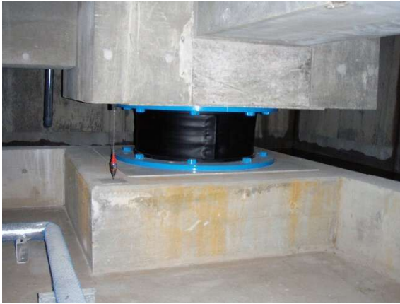
写真-1 免震ゴム（市庁舎）
