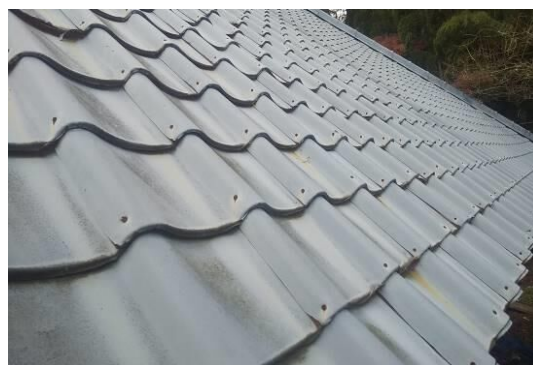
瓦型鉄板葺に発生した錆
