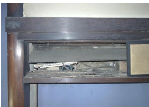
オク天袋内の天井板の外れ
