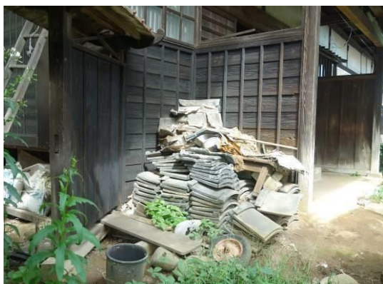
板壁に接して置かれた資材等
