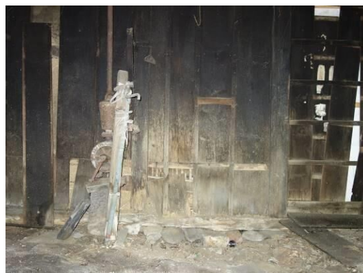
板壁の汚損（ドマ（奥））
