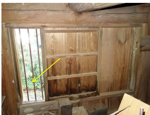
2階の面格子の錆
