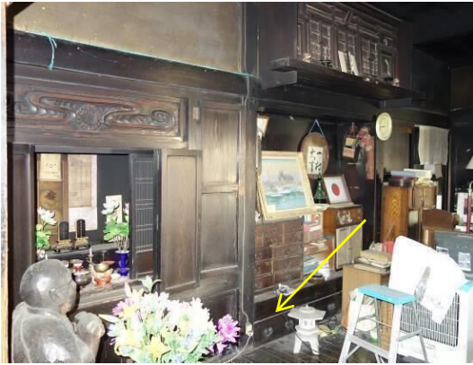
ザシキ押板下部の棚の破損状況
