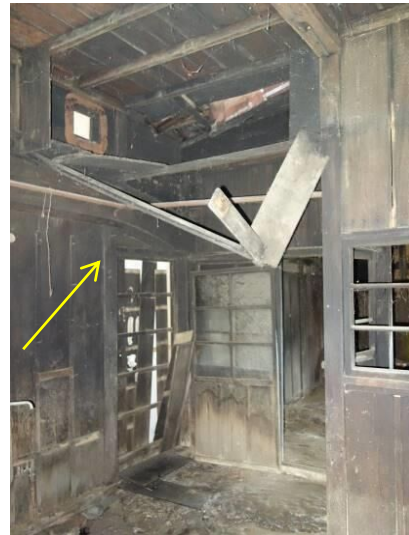
ドマ（奥）の上部棚の崩壊
