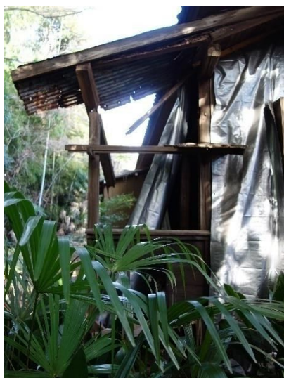
南西隅のベンジョの破損状況
