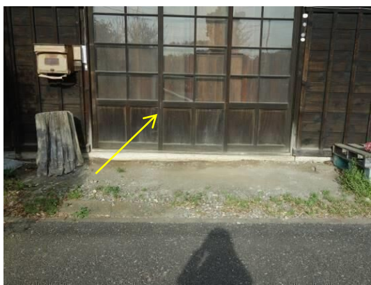
正面建具のガラスの割れ
