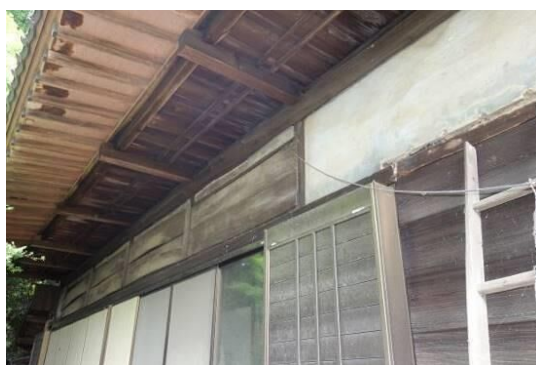
垂木裏板の染み
