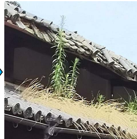
経年劣化により屋根瓦が崩落した例
