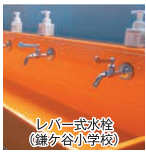
レバー式水栓 (鎌ヶ谷小学校)
